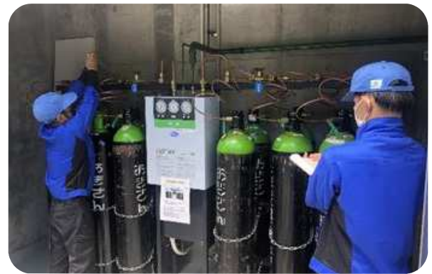
医療ガス供給設備 (メンテナンス)
