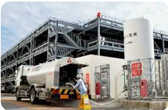
医療ガス供給設備 (液化酸素貯槽)
