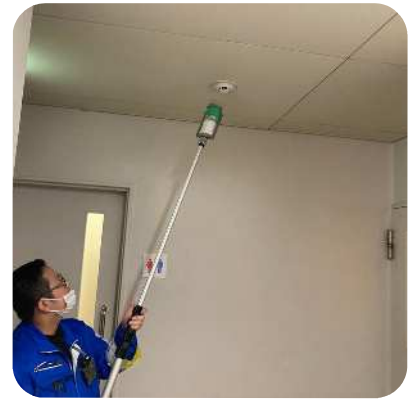
消防設備点検
